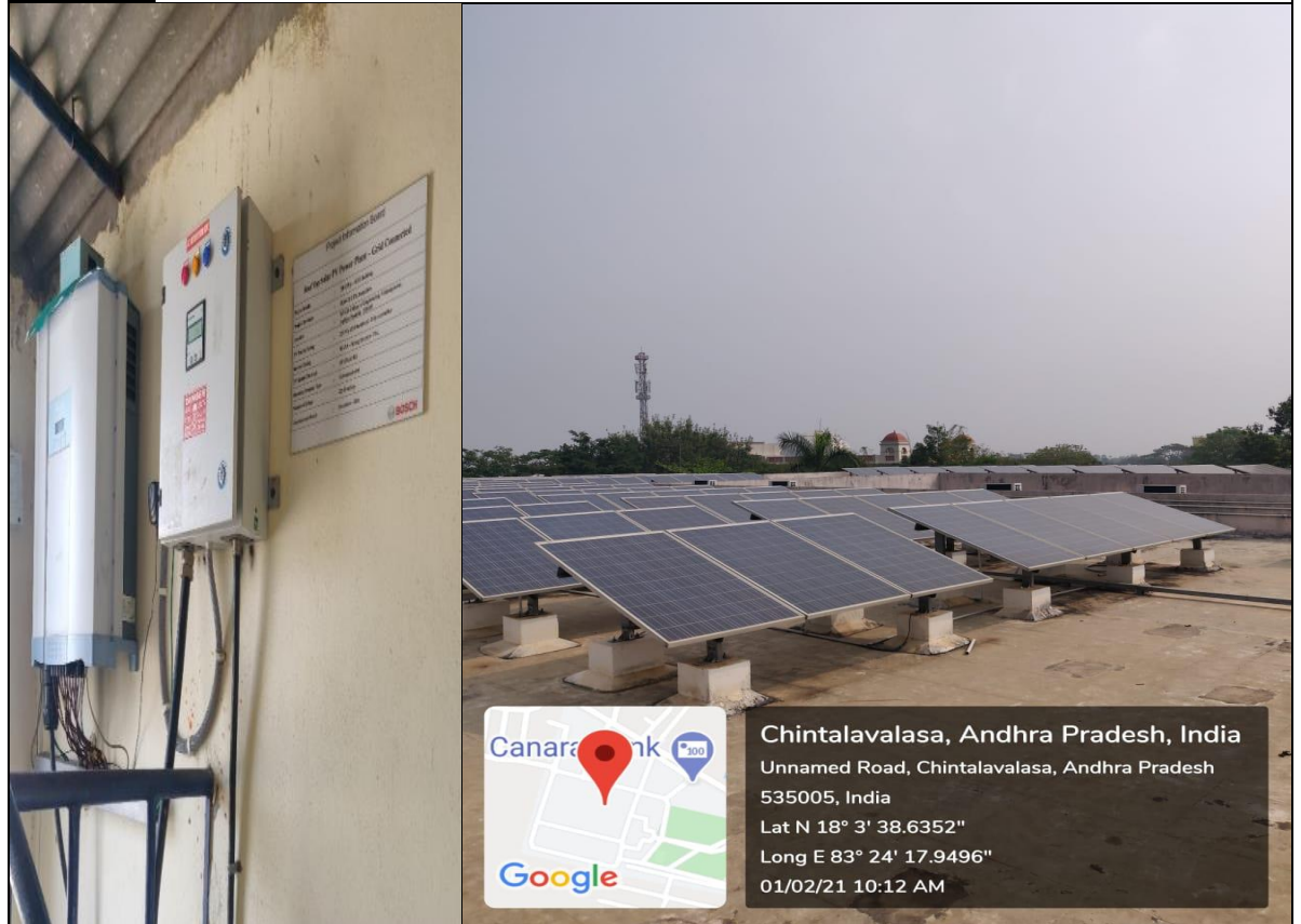
S.No. 27: Solar Panel
